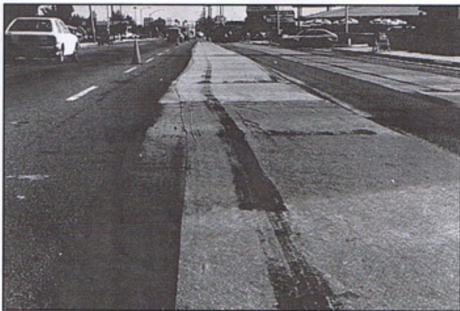
Esta tela fue instalada incorrectamente.
