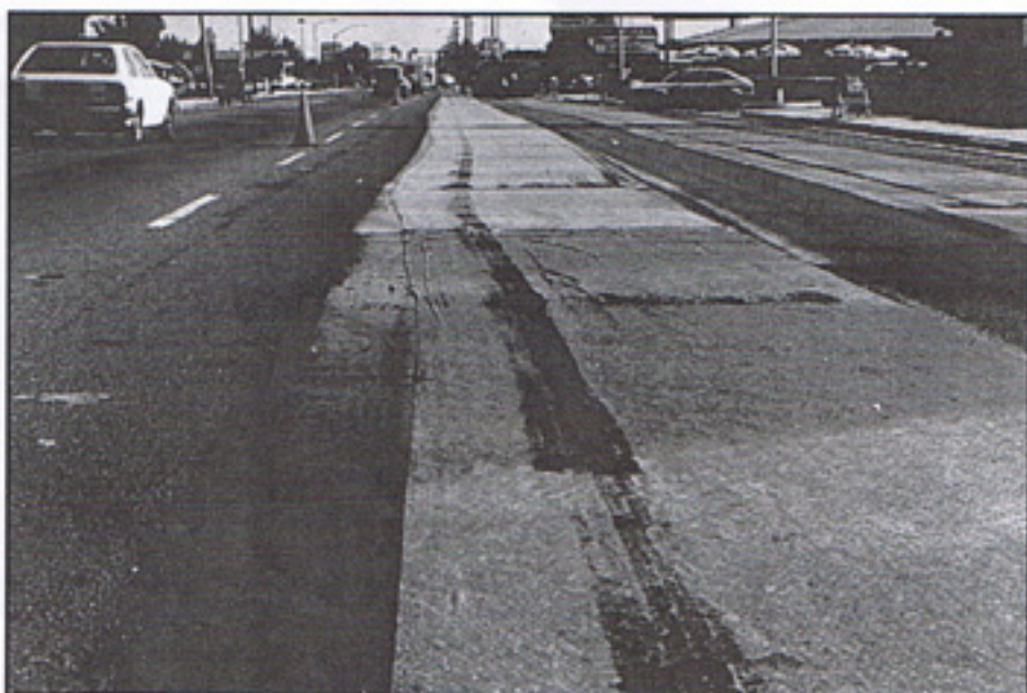
Esta tela fue instalada incorrectamente.
